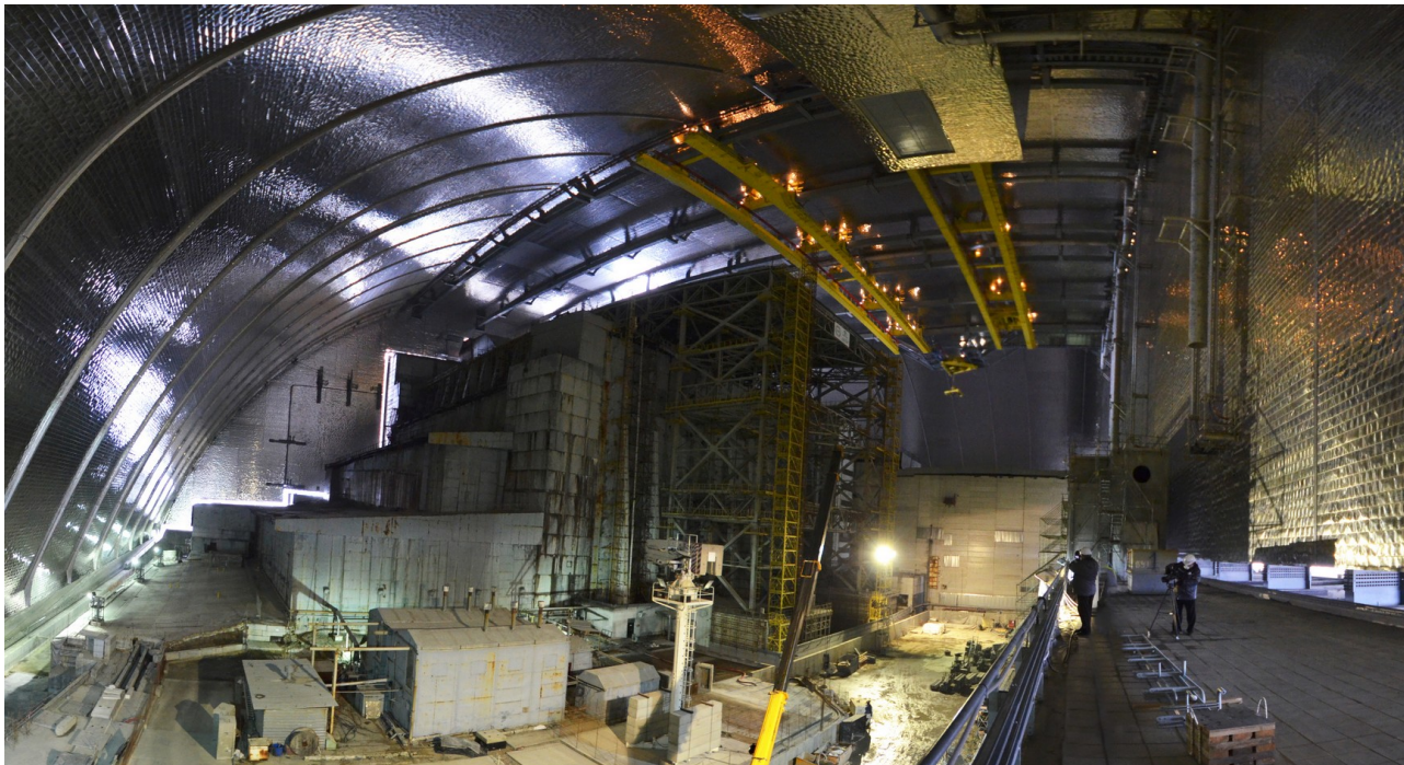
Figur 1. Panoramabild inuti den nya valvformade sarkofag som sedan 2016 täcker den gamla sarkofagen över den havererade reaktor 4 i Tjernobyl. Sarkofagen är 108 meter hög, 162 meter lång och har en spännvidd på 257 meter. Syftet med konstruktionen är att skydda den inre sarkofagen från väder och vind samt att agera strålskydd för personal som arbetar i närområdet. Bildkälla: State Specialized Enterprise "Chernobyl NPP" [1].
